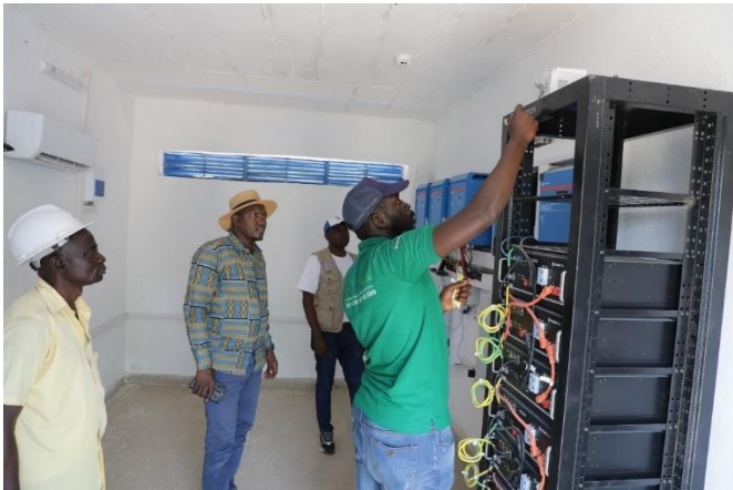
Des installations modernes Photo: Unité de Communication du PNUD
